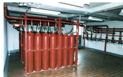
Instalação de CO 2 de Alta Pressão para um CPD. Distribuição com válvulas direcionais (lado direito da foto).
